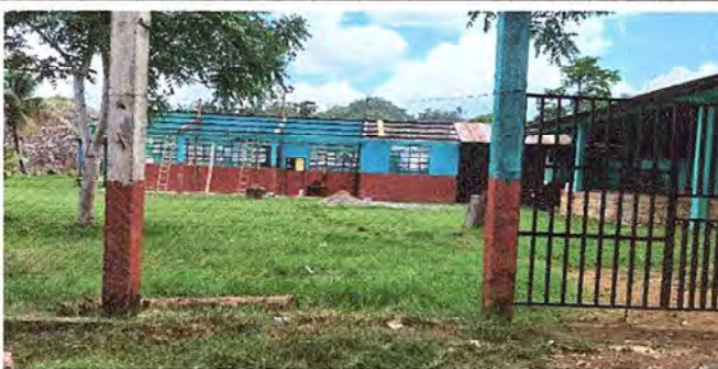
Foto 5: Cubierta de lamina deteriorada a sustituir desmontada en su totalidad.
